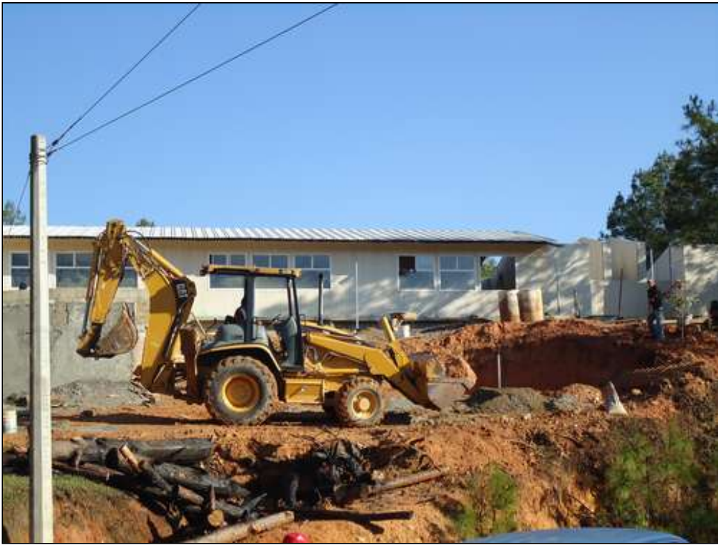
Habitantes del pueblo de San Miguel Chimalapa, región del Istmo, denunciaron que el gobierno de Chiapas continúa con las edificaciones en la superficie comunal del pueblo indígena zoque. En la imagen, parte de la maquinaria que utiliza el estado vecino para trabajar en la zona zoque. Foto Foto La Jornada
